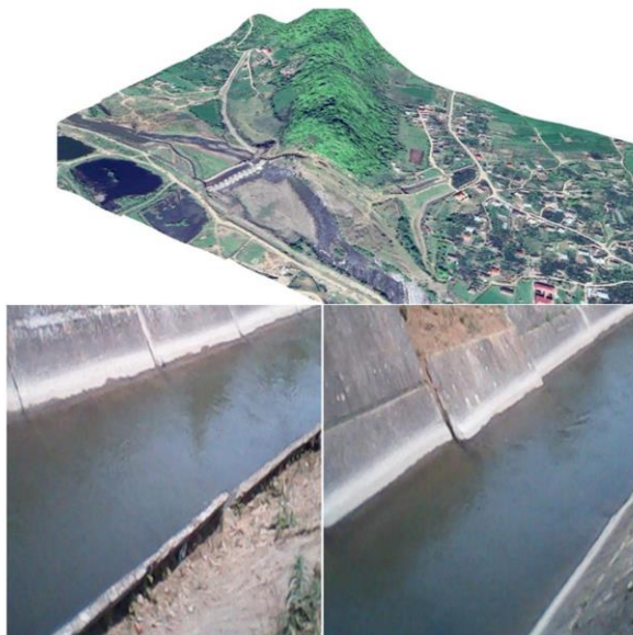
Рис. 3. Вид Ленкоранчайского канала и фотографии разрушения его конструкции
